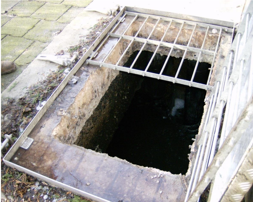
Put van een drooggemaal
