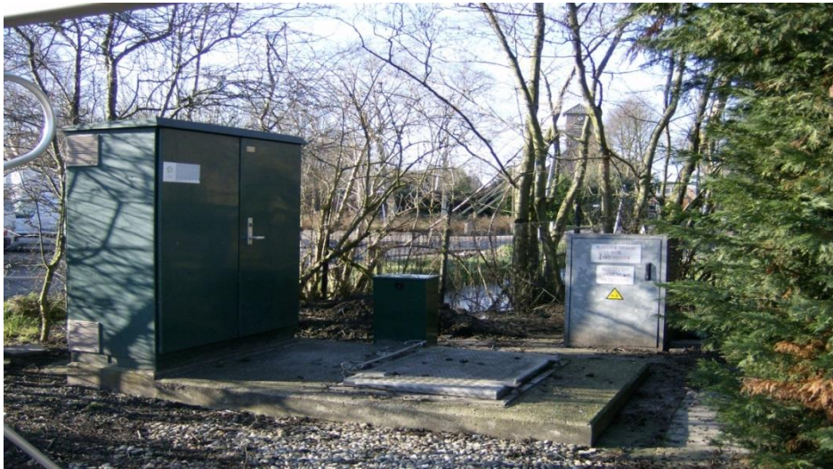
Opstelling nat rioolgemaal
