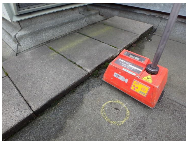
Foto 12 Beschadiging in het dakvlak nabij installatie (meetwaarde 2515)
