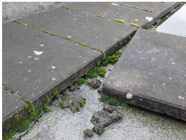
Foto 2 Vervuiling door mosgroei bij betontegels
