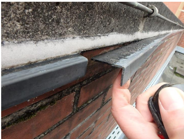
Foto 13 Onthechting druipprofiel / kitvoeg dakrand
