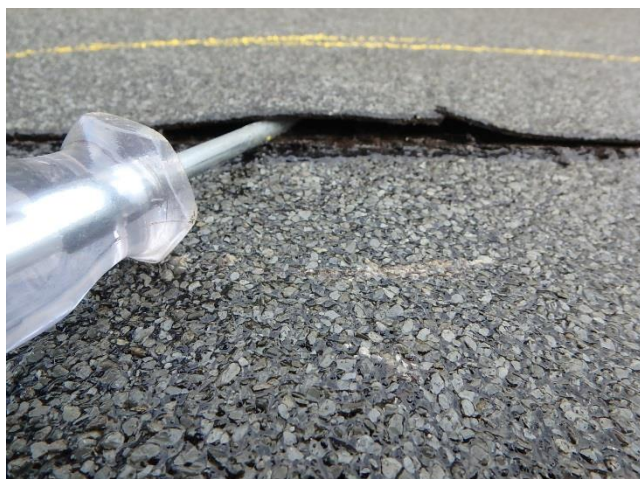
Foto 87 Onthechting overlap van een dakbaan
