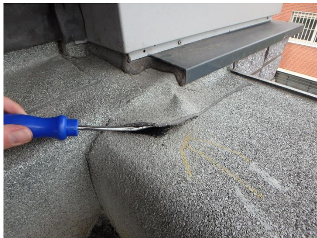
Foto 104 Onthechting overlap aansluiting dakrand met opstand
