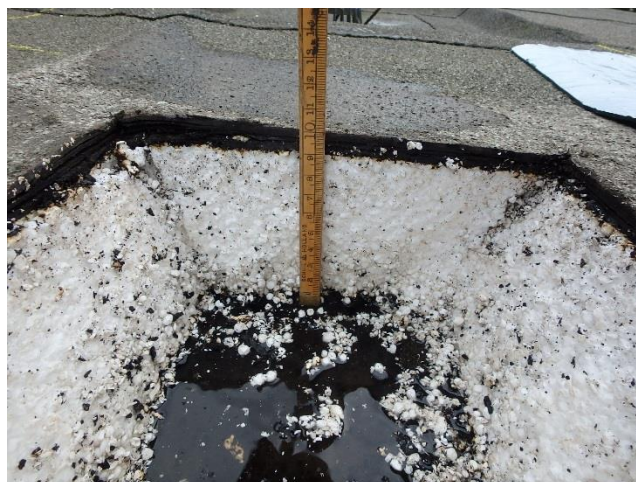
Foto 56 De isolatie is nat, er staat water op de dampremmende laag
