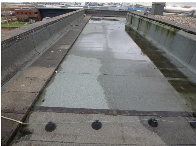
Foto 63 Overmatige plasvorming door een dichtgezette hemelwaterafvoer
