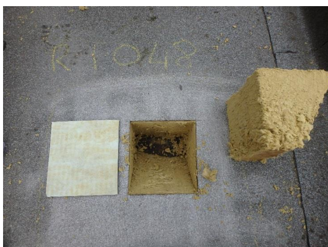
Foto 107 Insnijding meetwaarde 1048 (betondak)
