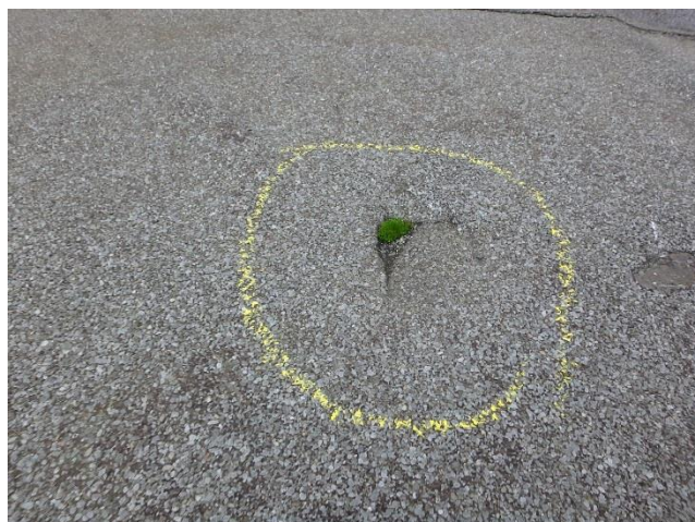
Foto 64 Een beschadiging in de dakbedekking
