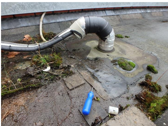
Foto 17 Onthechting reparatiestuk bij kabeldoorvoer
