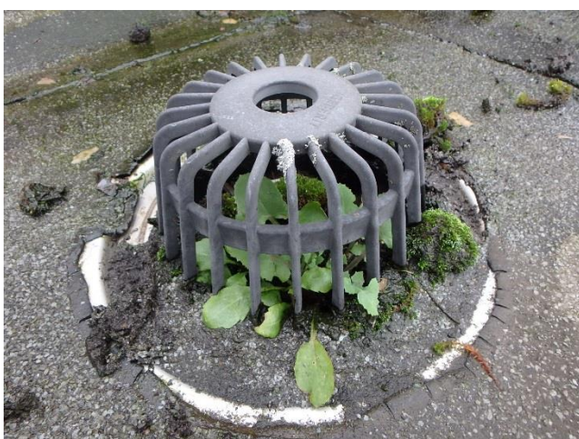
Foto 53 Vervuiling van een hemelwaterafvoer
