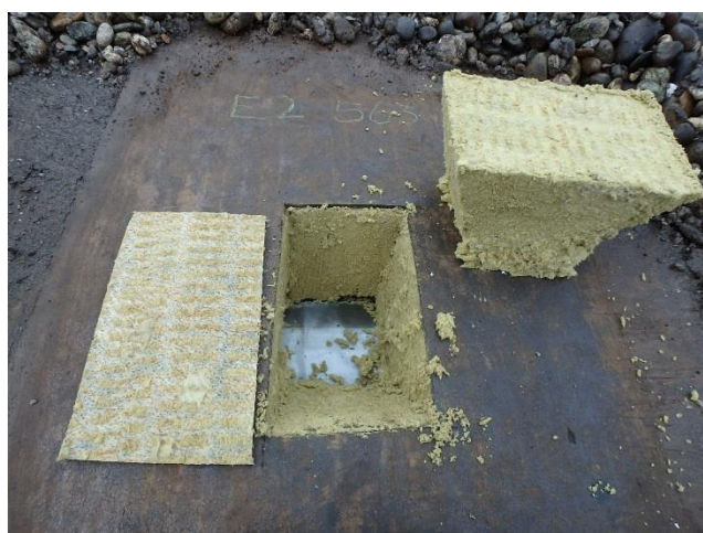
Foto 60 Insnijding meetwaarde 563 (staaldak), de isolatie is droog
