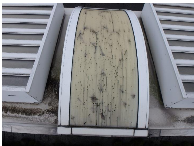
Foto 59 Perforaties lichtstraat (hagelschade)
