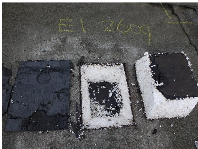
Foto 55 Insnijding meetwaarde 2609 (betondak)
