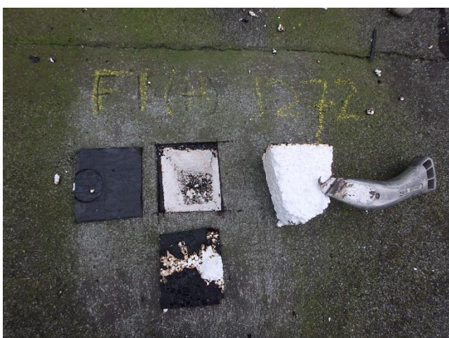
Foto 65 Insnijding meetwaarde 1272 (betondak)
