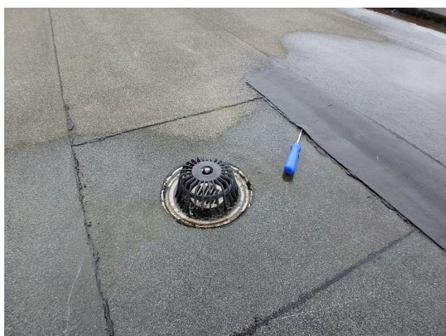
Foto 23 Onthechting reparatiestrook bij hemelwaterafvoer
