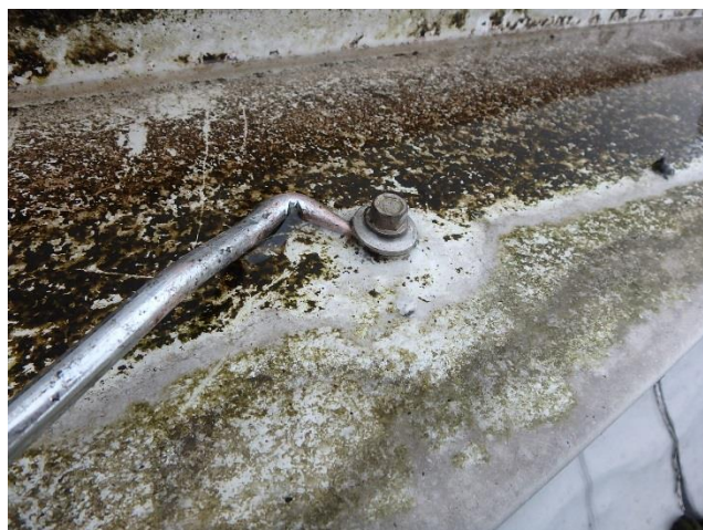
Foto 70 Verouderde afdichtingsschroeven rookluiken
