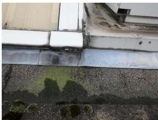
Foto 90 Scheurvorming in loodslabbe opstand
