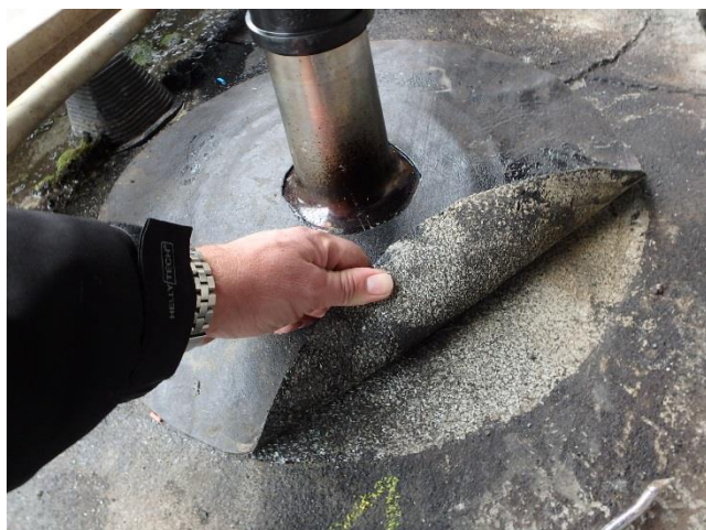
Foto 105 Onthechting plakstuk kabeldoorvoer
