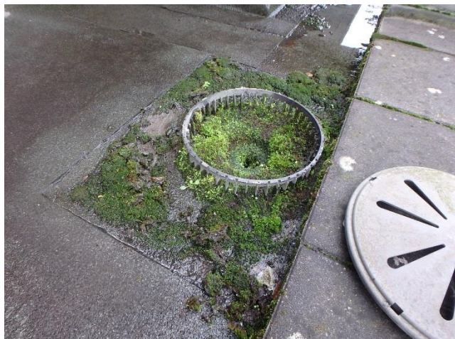
Foto 103 Vervuiling van een hemelwaterafvoer
