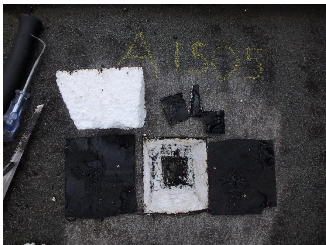
Foto 7 Insnijding meetwaarde 1505 (betondak), de isolatie is droog
