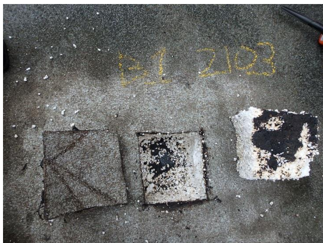
Foto 19 Insnijding meetwaarde 2103 (betondak)
