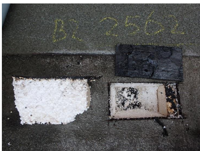
Foto 29 Insnijding meetwaarde 2562 (betondak)
