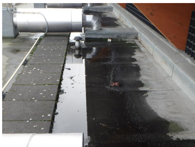
Foto 102 Plaatselijk overmatige plasvorming
