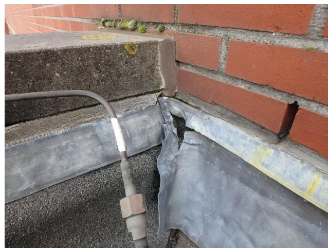
Foto 26 Onjuiste aansluiting dakrand met opstand
