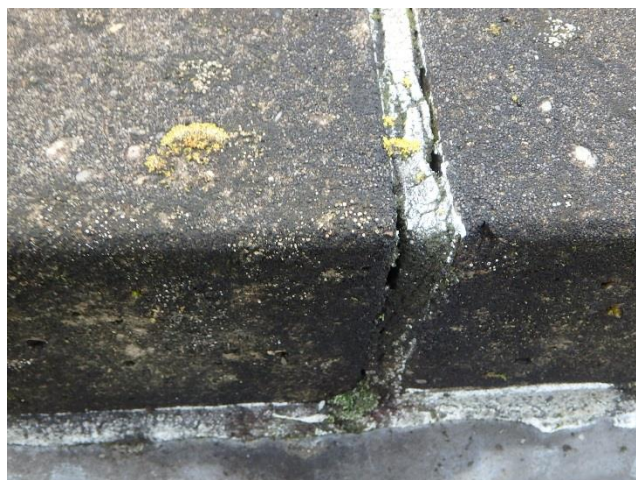
Foto 36 Onthechting kitvoegen betonelementen dakrand
