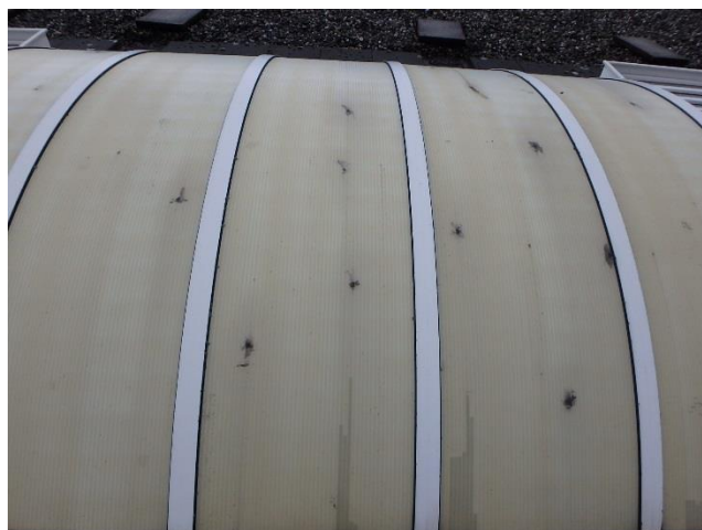
Foto 48 Perforaties lichtstraten (hagelschade)
