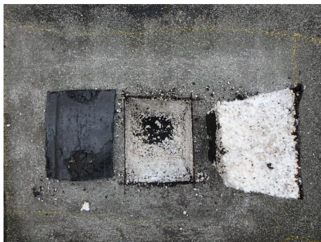
Foto 82 Insijding meetwaarde 2055 (betondak), de isolatie is zeer vochtig
