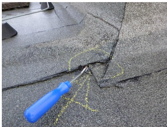
Foto 38 Onthechting opstandstrook liftopbouw
