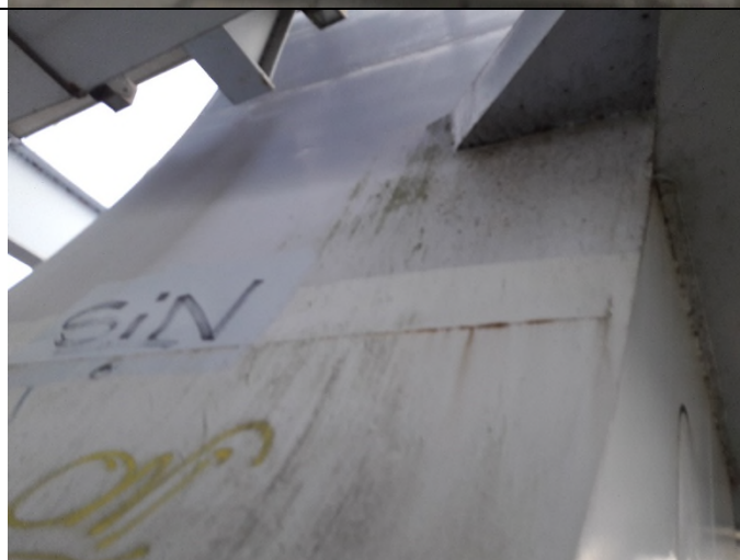
Pyloon, roestende las, vermoedelijk met scheur (noord- en zuidzijde pyloon) Tekening 6, 9 AL (04)
