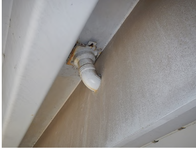
HWA, afvoerleiding Haakse bochten. Foto bij HWA-kolk fietspad (algemeen beeld)
