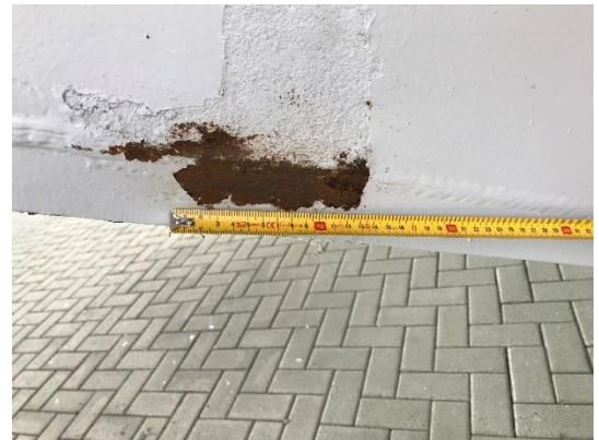
Afbeelding 16: Corrosie rondom lasnaad
