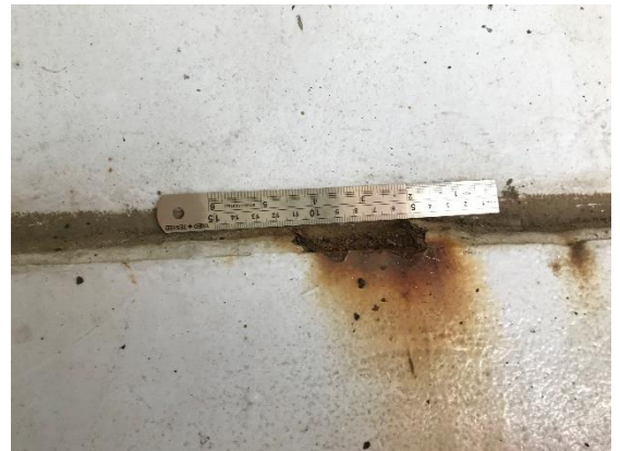
Afbeelding 8: Corrosie t.p.v. aansluiting
