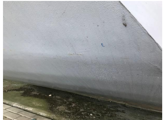
Afbeelding 20: Bolling bestaande uit plamuur t.p.v. aansluiting
