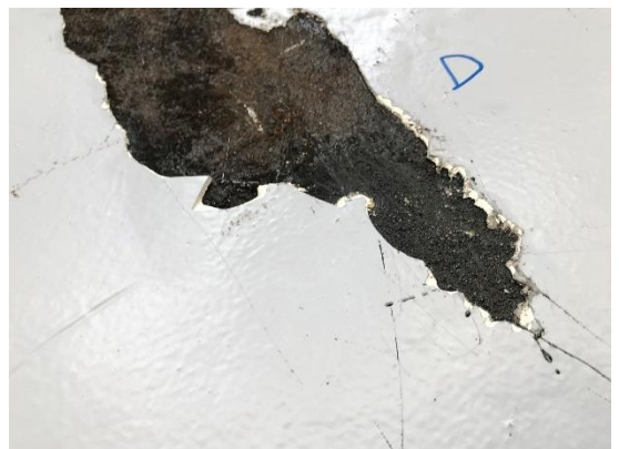
Afbeelding 18: Vocht onder afwerklaag
