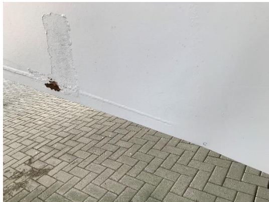
Afbeelding 15: Schilderwerk met daarachter corrosie
