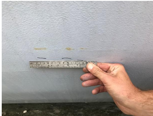
Afbeelding 19: Corrosie bij aansluiting.scheurtjes in coating
