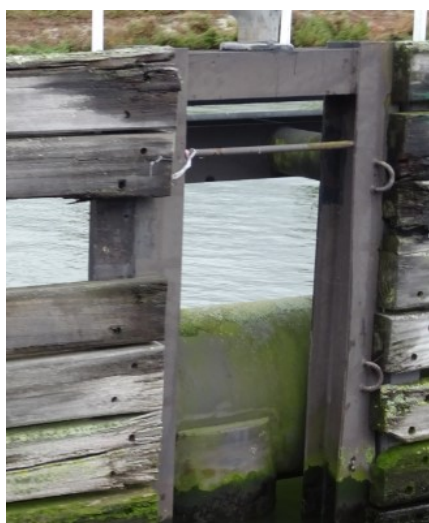
Figuur8: Een voorbeeld van een segment met een ontbrekende bevestigingsframe
