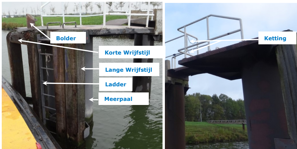
Figuur2: afmeervoorziening op de Noordelijke voorhaven
