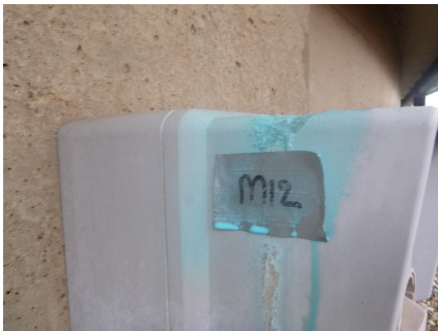
Foto F39, Elektrakast - Voorbezinktank
