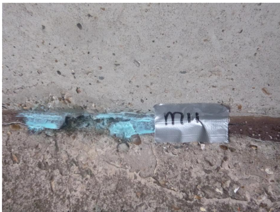
Foto F37, Afdichtingskit type 6 - Voorbezinktank
