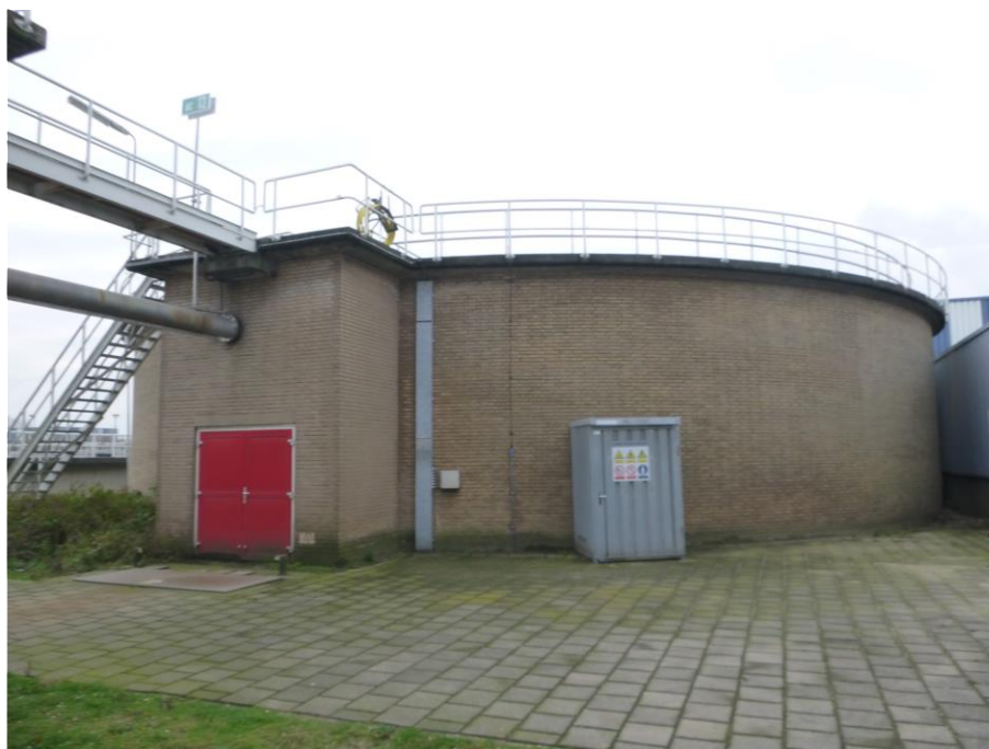
Foto F23, Afdichtingskit type 3 - NA - Indiktank (NIT)
