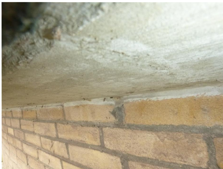
Foto F25, Afdichtingskit type 3 - NA - Indiktank (NIT)
