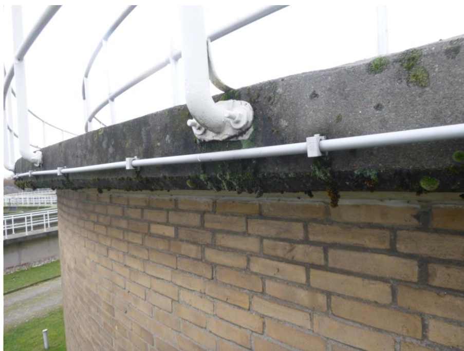
Foto F24, Afdichtingskit type 3 - NA - Indiktank (NIT)
