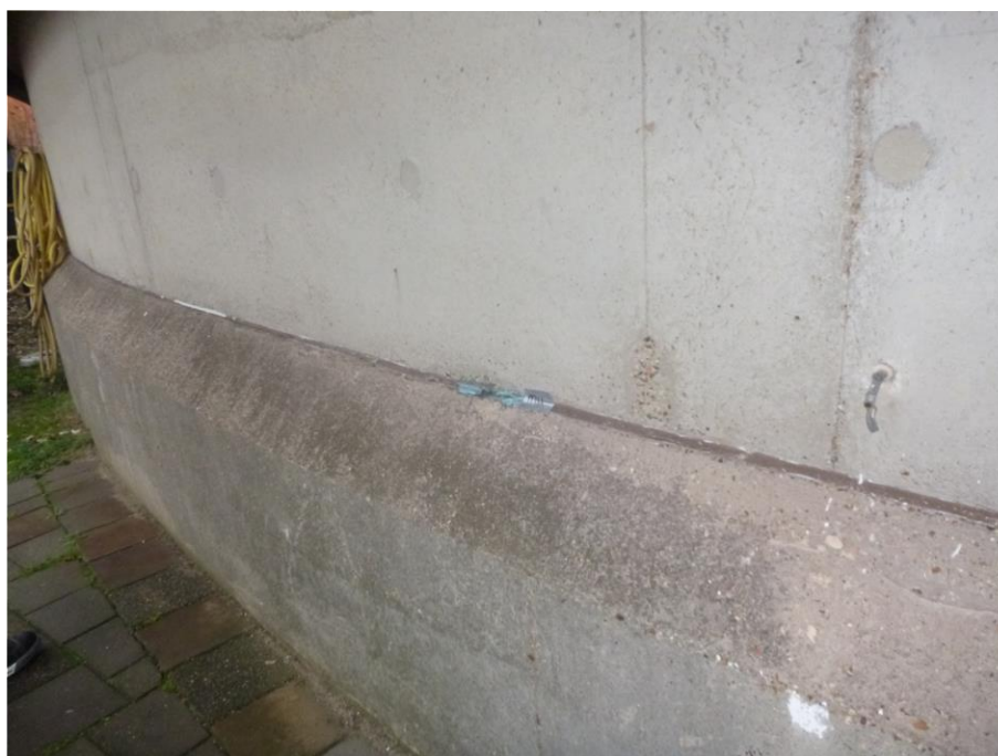
Foto F38, Afdichtingskit type 6 - Voorbezinktank
