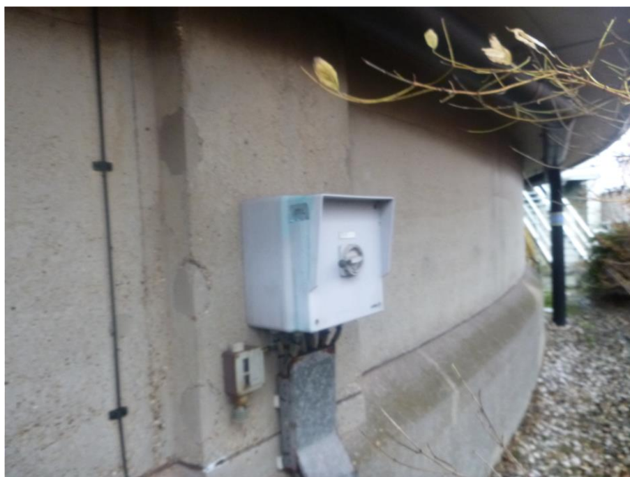
Foto F40, Elektrakast - Voorbezinktank
