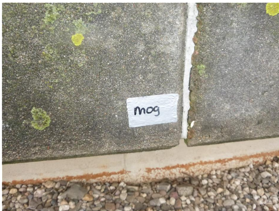
Foto F31, Afdichtingskit type 4 - Nabezinktank 2
