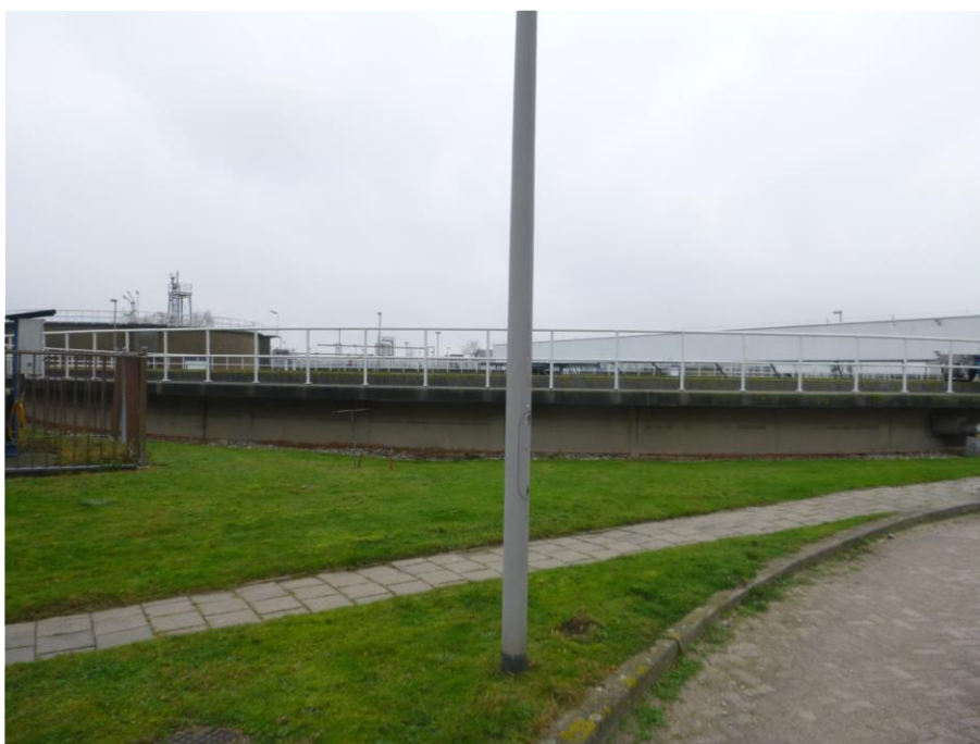
Foto F30, Afdichtingskit type 4 - Nabezinktank 2
