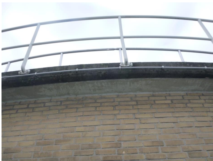
Foto F26, Afdichtingskit type 3 - NA - Indiktank (NIT)
