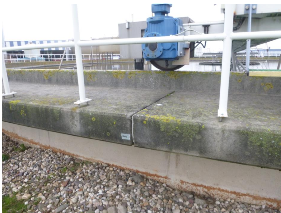
Foto F32, Afdichtingskit type 4 - Nabezinktank 2
