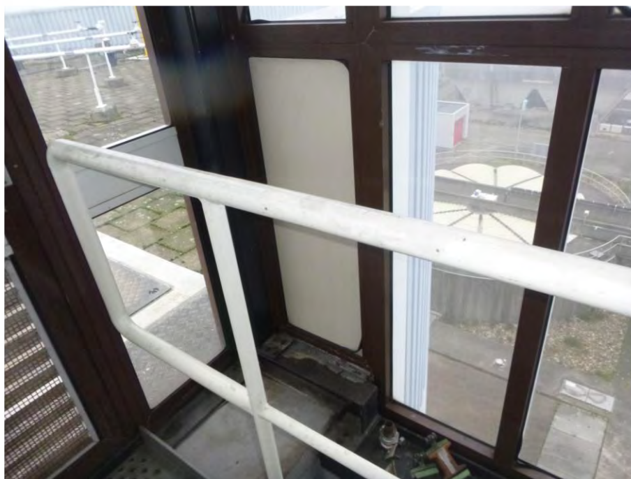
Foto F23, Gevelbeplating type 2 - Sliggistingstank 1 & 2
