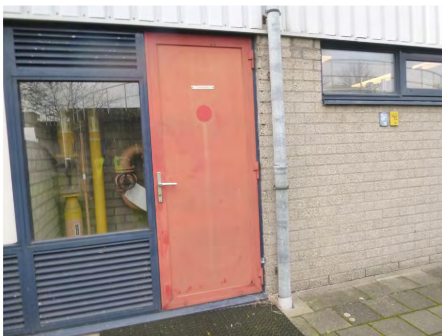
Foto F60, Afdichtingskit type 1 - Dienstgebouw 01
