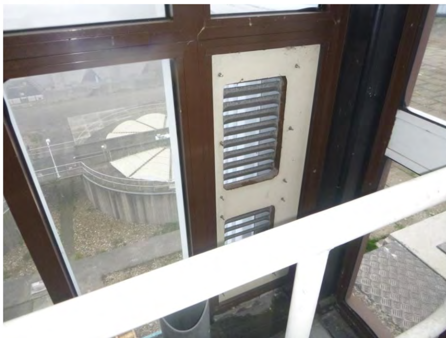
Foto F25, Gevelbeplating type 2 - Sliggistingstank 1 & 2
