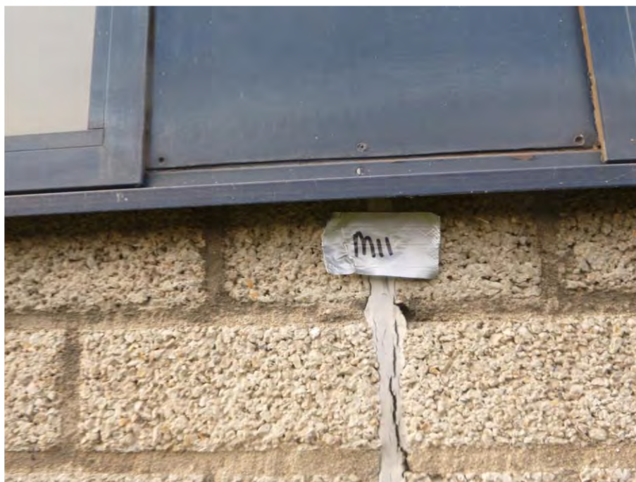
Foto F57, Dilatatiekitt type 2 - Dienstgebouw 01
