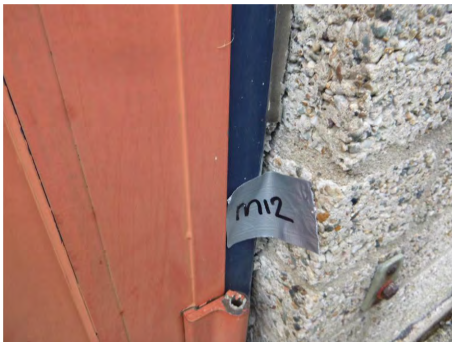
Foto F59, Afdichtingskit type 1 - Dienstgebouw 01
