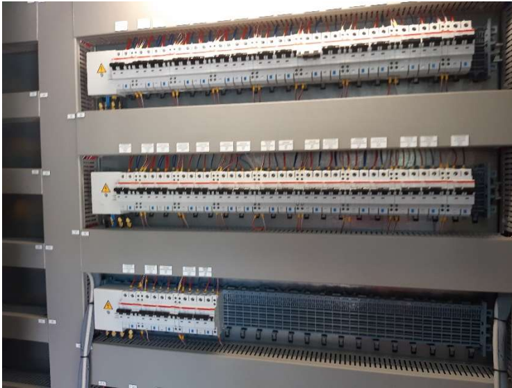
Figuur 24 paneel 2 van MCC/MRL-SL-01t.b.v. de stroomautomaat
