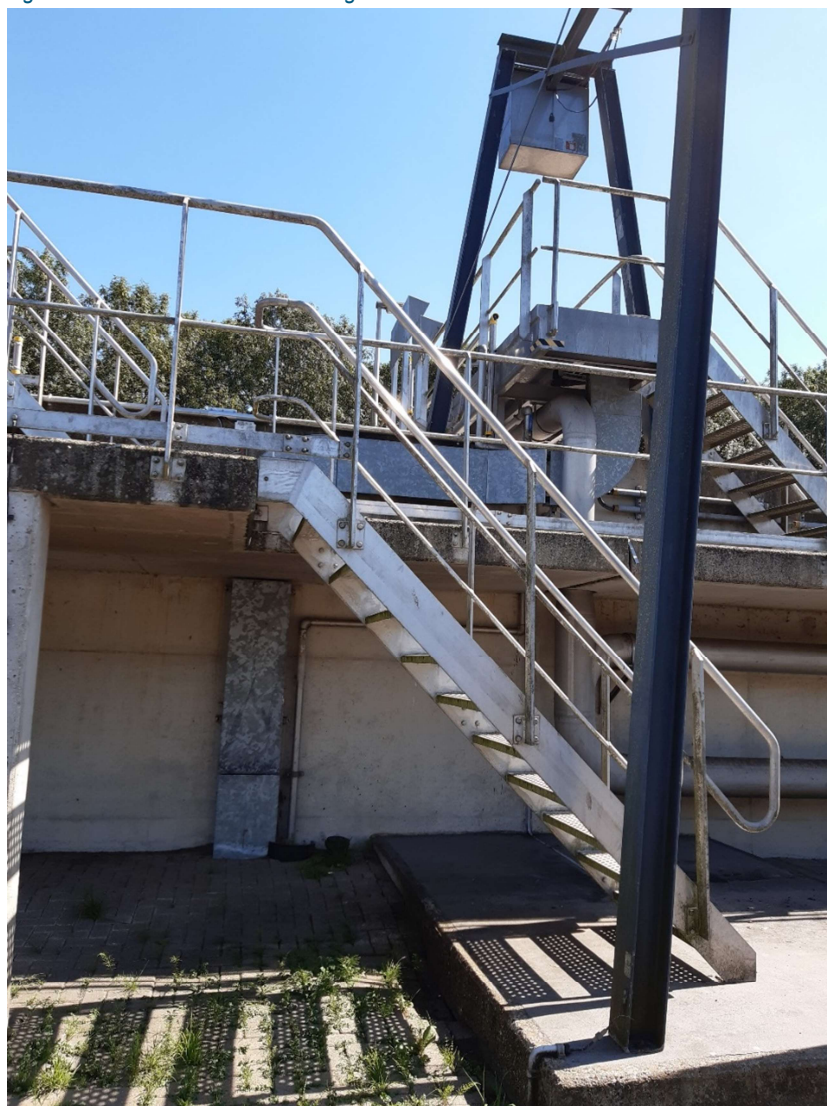
Figuur 16 Bestaande verticale kabelgoot met deksel bij BT2
