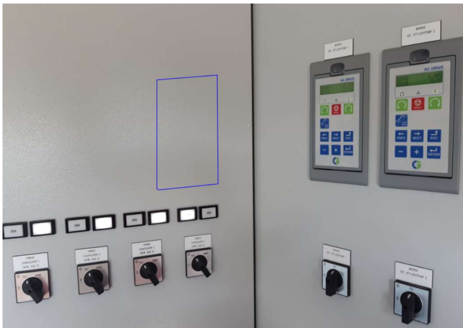
Figuur 25 Locatie bedienpanelen gef. effluentpompen
