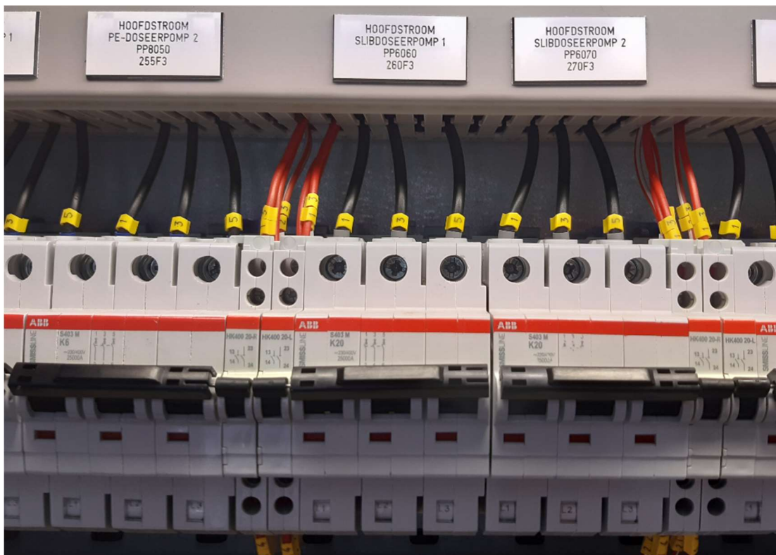
Figuur 21 Bestaande hoofdstroom automaten P_6060 en P_6070 IN mcc/mrk-sl-01
