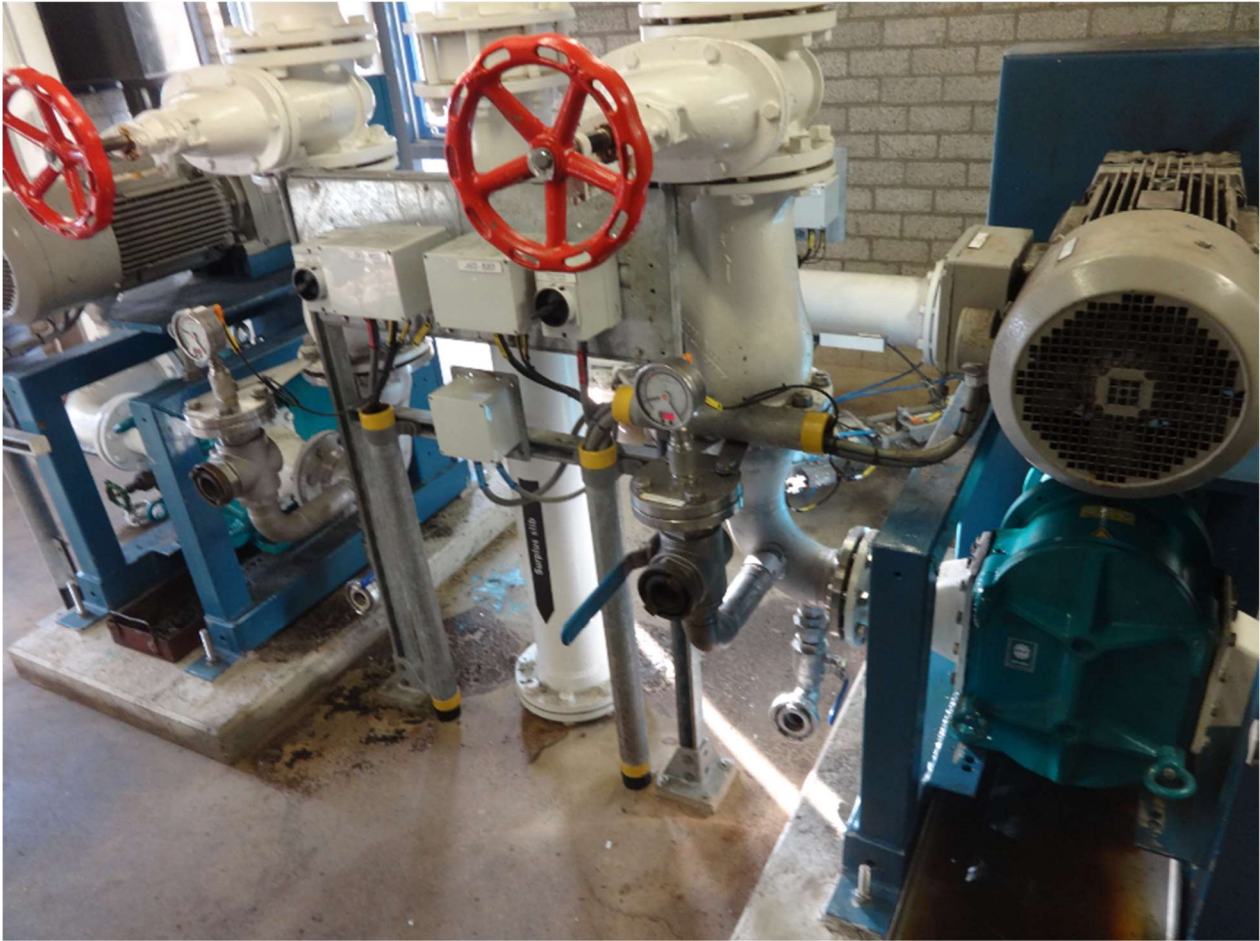
Figuur 22 Bestaande pompopstelling met in het midden de lasdozen JBD-8001 en JBD-8002
