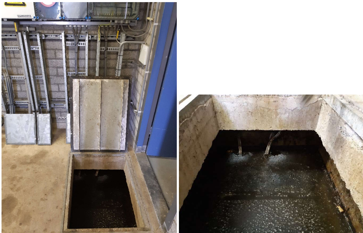
Figuur 5 kruipruimte welke vol water staat. (toegangsluik is voor LVK/KVK-ALG-04)
