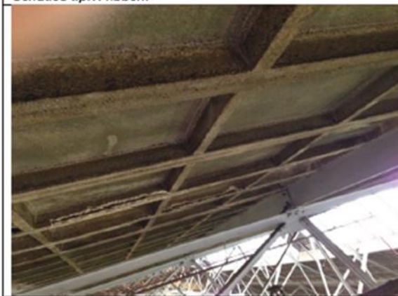
Forse schade aan een rib.
