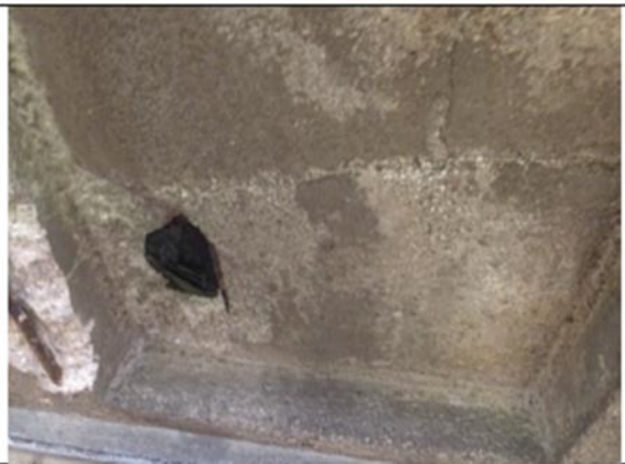
Scheuren aan het oppervlak van een element.
