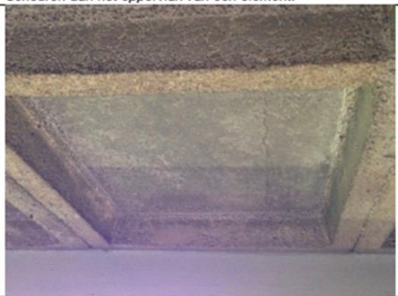
Dwarsscheur in het oppervlak.
