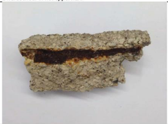
Stuk afgedrukt beton door corrosie ingeleid.
