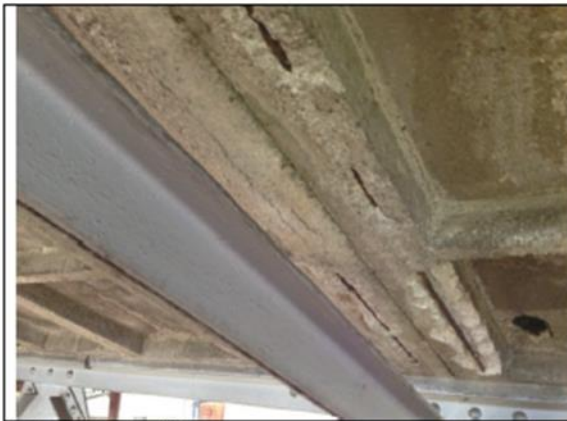
Schades t.p.v. ribben.
