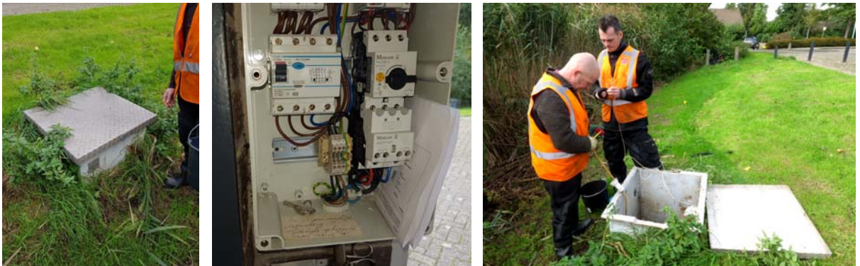
Figuur 10: Het openen van het afsluitluik, het demonteren van de rode 400V stekker en het vastmaken van het trekkoord aan de kabel.
