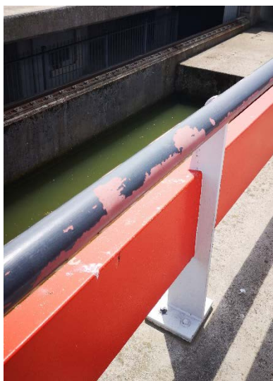
Figuur 4-3 -detail achterstallig schilderwerk
