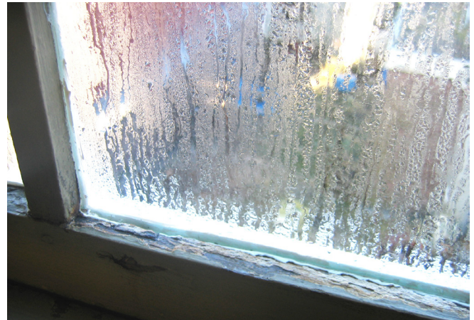
Figuur 7. Een museaal binnenklimaat met bevochtiging brengt vaak risico's met zich mee voor historische gebouwen. Zo leidt condensatie van waterdamp tot houtrot van bijvoorbeeld constructiedelen of kozijnen.
