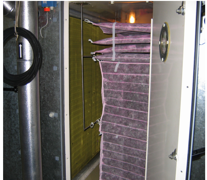
De filters in luchtbehandelingskasten zorgen voor een drukverschil. Hoe meer filters worden toegepast hoe groter dit drukverschil en hoe hoger de frequentie van de ventilator is en hoe meer energie verbruikt wordt.
