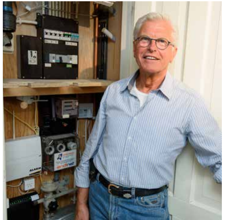
Peter van der Kamp bij zijn meterkast in zijn woning.
