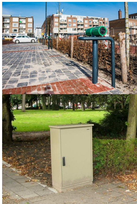
Figuur 3: laadplein (Arnhem) en systeemkast (voorbeeld)
