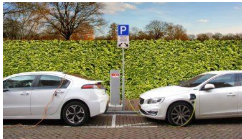
Figuur 1: Publieke laadpaal met netaansluiting
