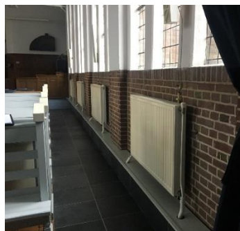
Radiatoren in de kerkzaal
