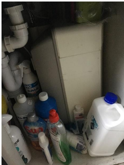
Elektra-boiler in de keuken
