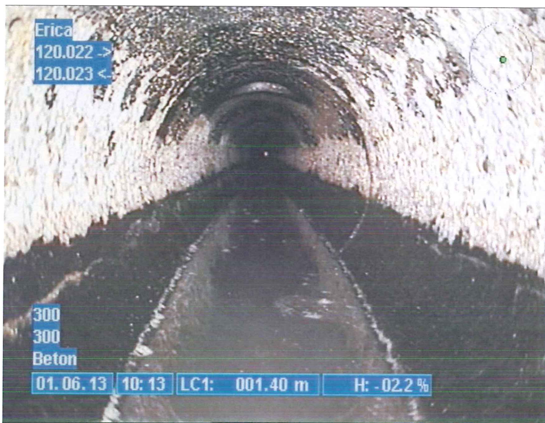
1.40 m1 Foto 06010195: Schade aan het oppervlak Toeslagstof steekt uit / wapening zichtbaar
