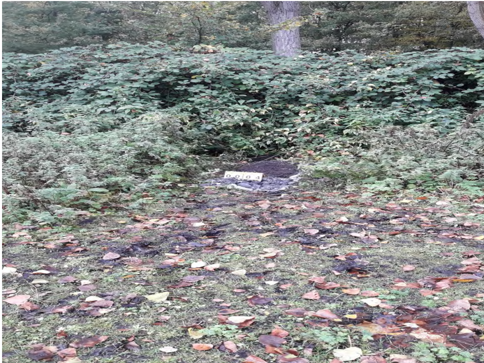
Fotonummer: 3 Omschrijving: asbestgat
