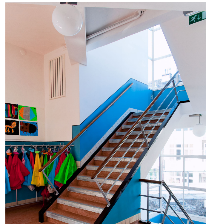
Minimale impact van klimaatinstallaties op het monument; afzuiging via trappenhuis. Openluchtschool, Amsterdam (Rijksmonument), WDJArchitecten
