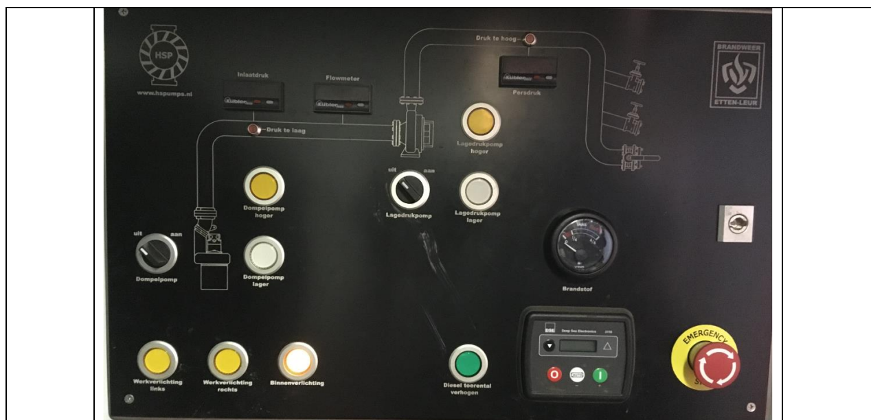
Voorbeeld dashboard pompinstallatie Etten-Leur
