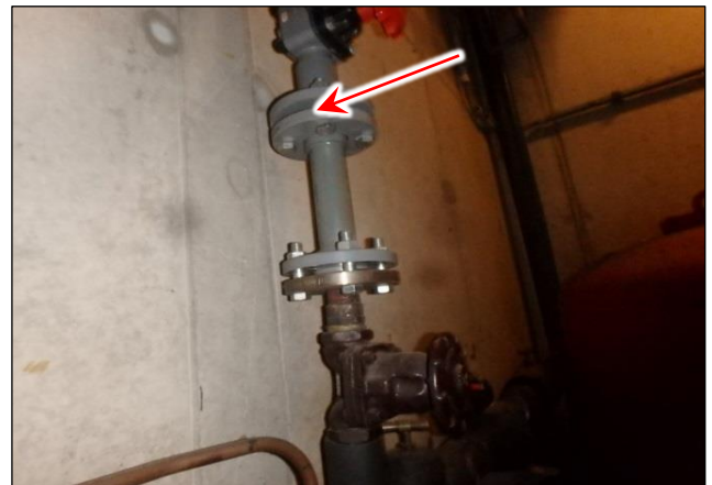
Pakkingen tussen flenzen Asbesthoudend
