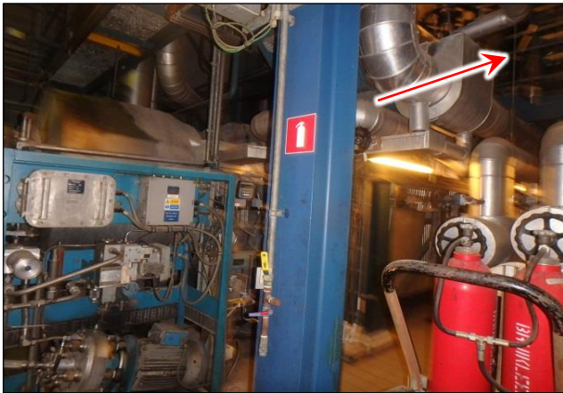
Pakkingen tussen flenzen Asbesthoudend
