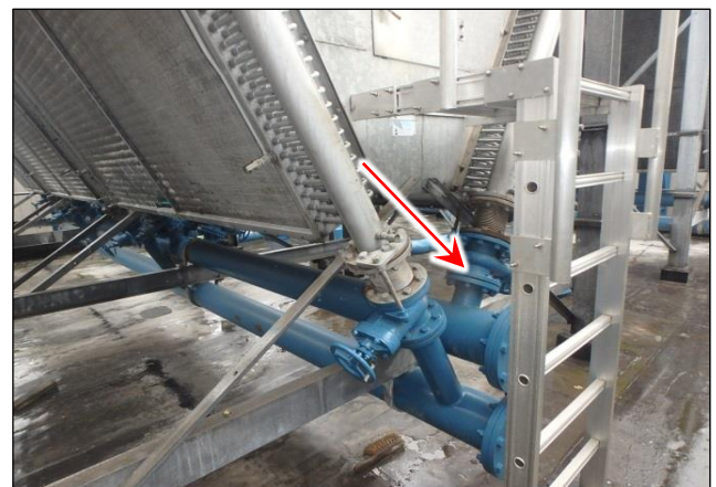
Pakkingen tussen flenzen Asbesthoudend
