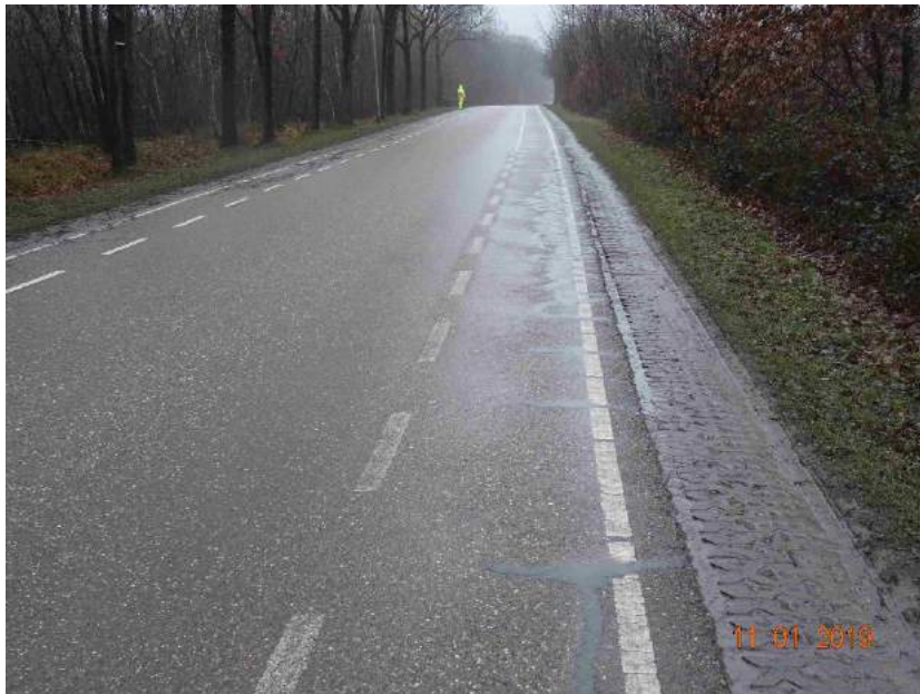
Figuur 2 Kenmerkende schade Waubacherweg en Grensweg
