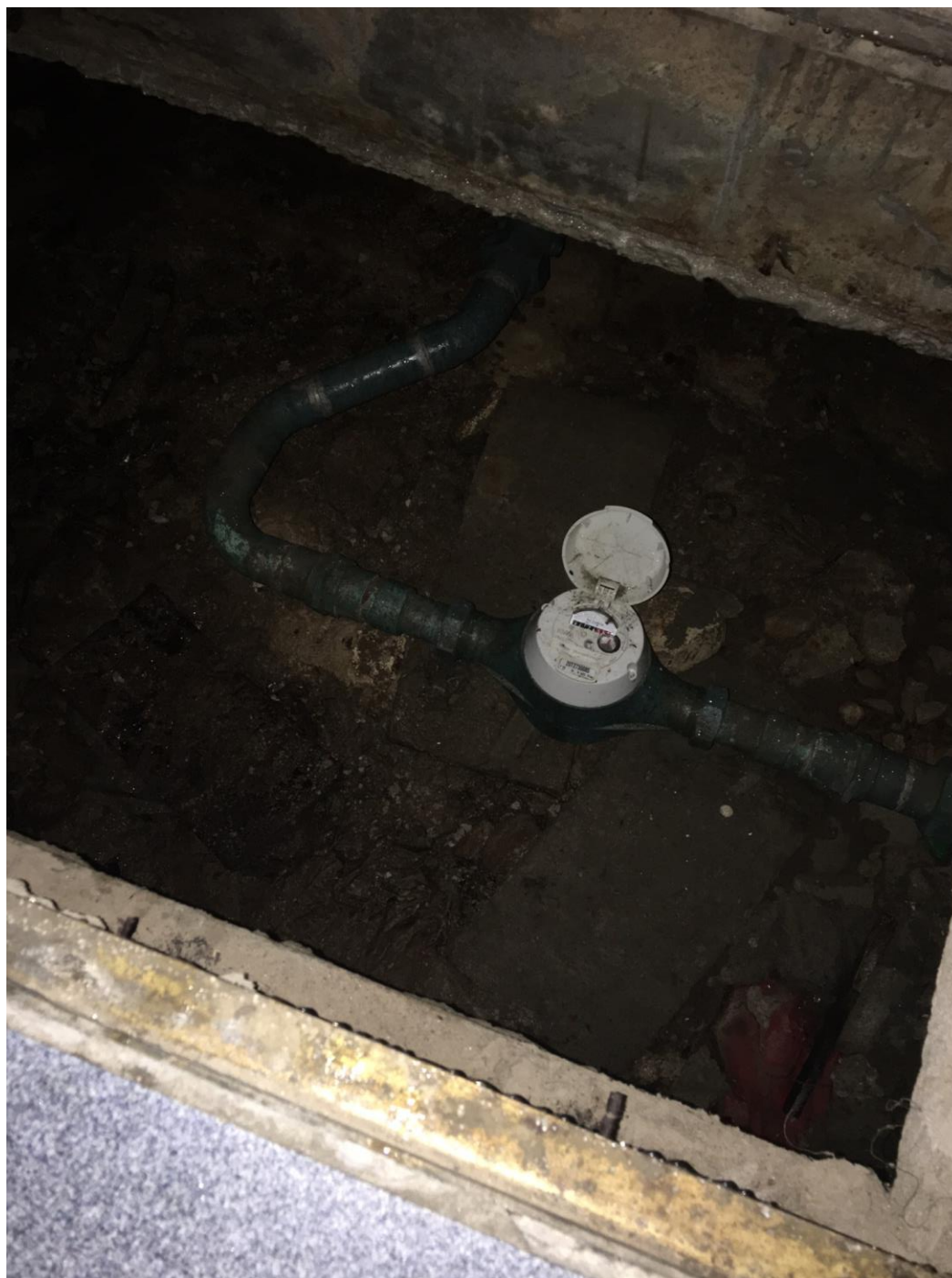
Foto 1: Watermeter in de beheerdersruimte
