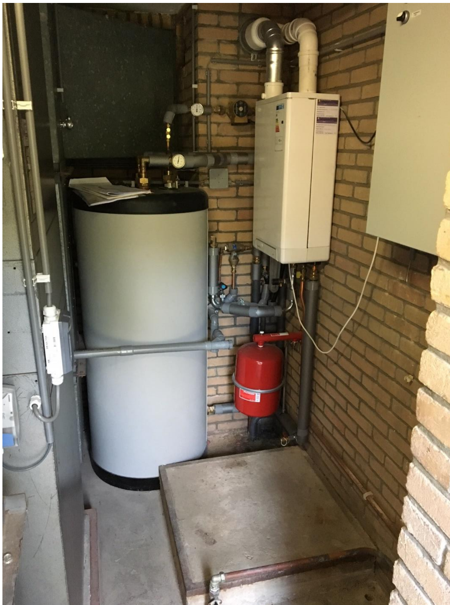
Foto 2: Technische ruimte met boiler opstelling
