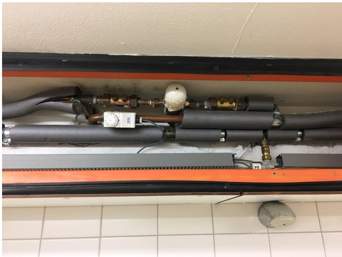
Foto 1: Één van de mengventielen in de doucheruimte
