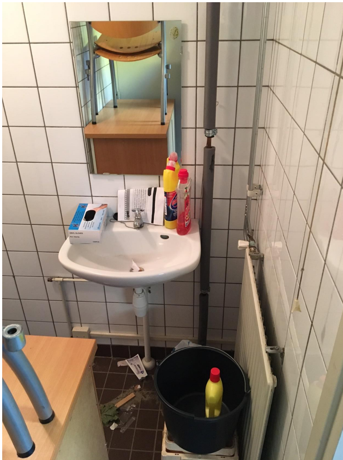
Foto 2: Niet gebruikte wastafel met dode leiding
