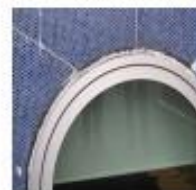
Lekkage rondom kozijnen
