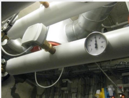
Temperatuursensor en – meter op centrale retour
