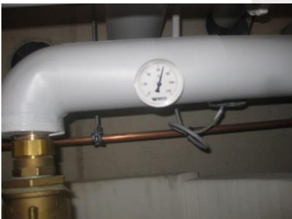
Temperatuurmeter centrale aanvoer
