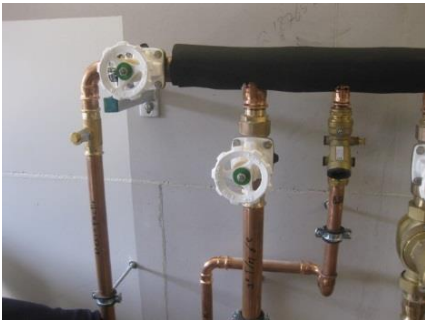
Links: bypass desinfectie
