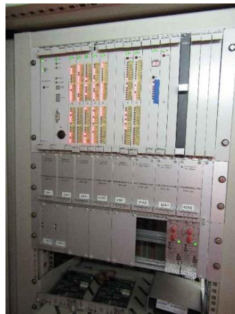
Afbeelding 2 Haagsche Schouwbrug schakelkast
