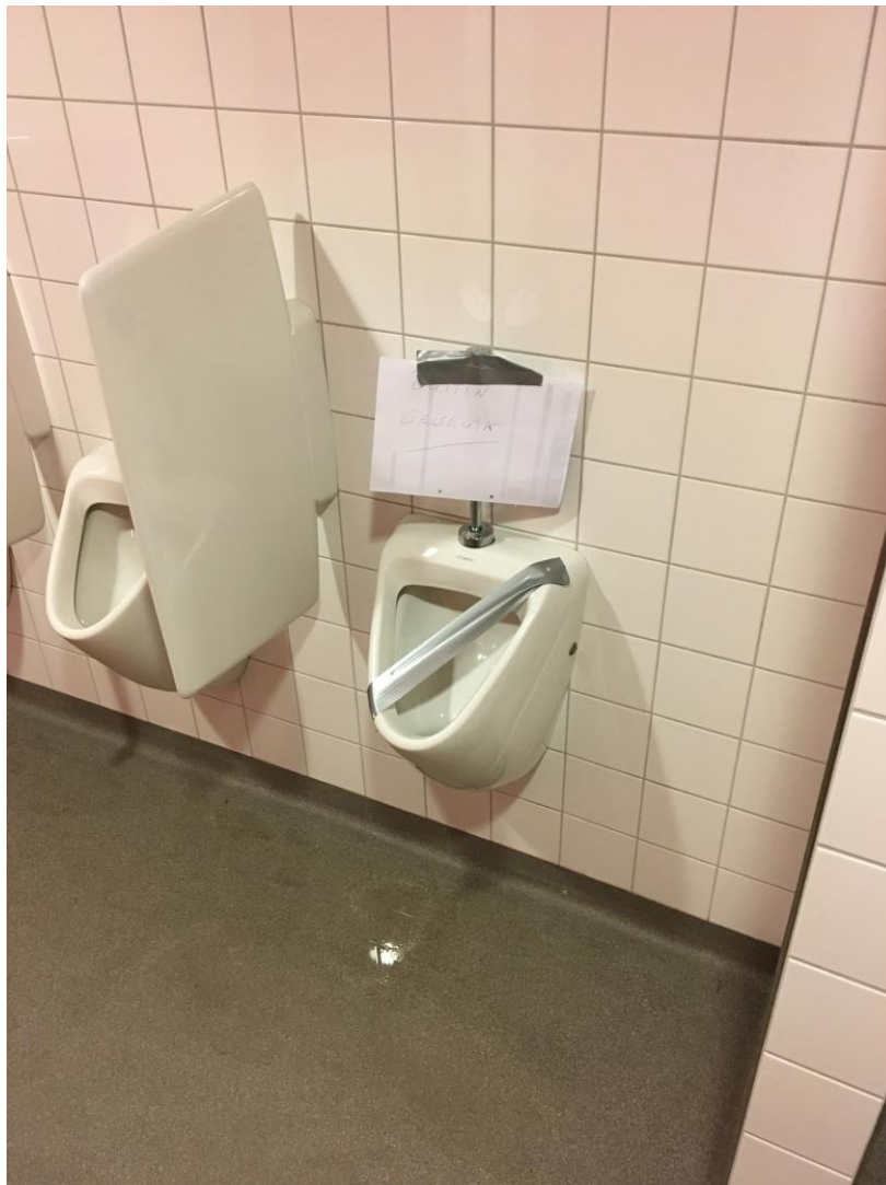
Foto 3: defecte tappunt welke stagnatie veroorzaakt
