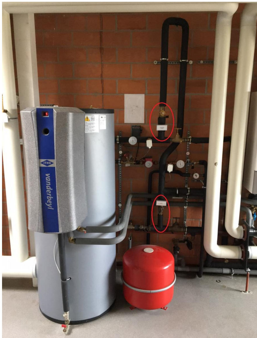
Foto 6: Bypass welke niet aftapbaar is en waarvan de afsluiter te ver bij de oorsprong vandaan zitten.
