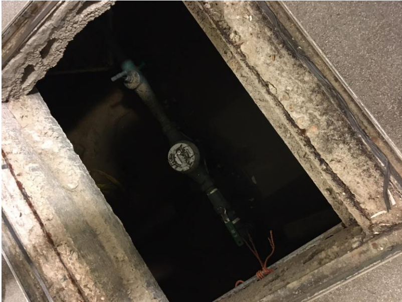
Foto 1: Watermeter in het jongeren centrum
