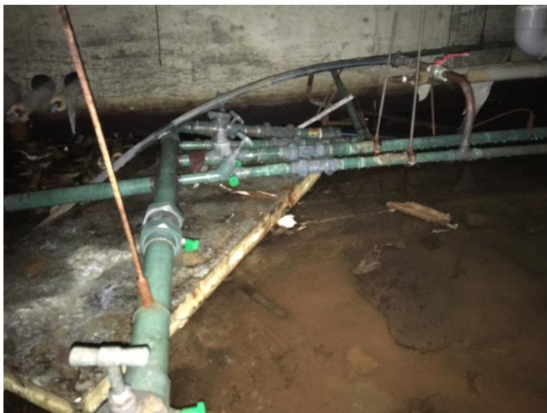
Foto 2: Toevoerleidingen onder de vloer van het jongeren centrum.
