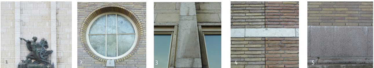
Fig. 1 - Frans Kalkstenen 'Bois fleuri' in de monumentale gevel. Fig. 2 - Stalen kozijnen en natuursteen waterhol. Fig. 3 – Profilering in Bois Fleuri rond de ramen. Fig. 4-5 verschillende kleurschakering van baksteen in het gevelbeeld.
