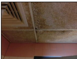
Lekkage plekken in plafondplaat
