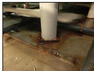
Corrosie aan voet zandfilters
