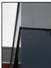
Corrosie t.p.v. bak
