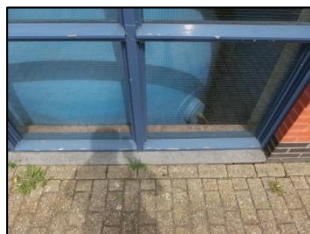
Ontbrekend schilderwerk pui WKK
