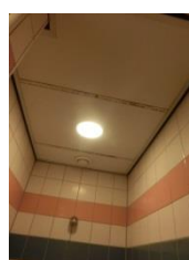
Corrosie aan raster
