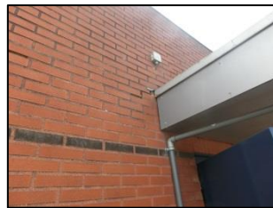
Vervuild voegwerk nabij uitgifte balie
