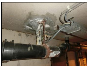
Corrosie aan ophanging
