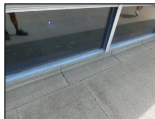
Matig schilderwerk kozijn bovendaks
