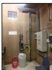
Doseerinstallatie en regeltechniek
