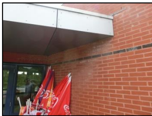
Vochtplek in gevel
