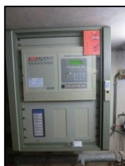
Paneel bij sprinklerinstallatie
