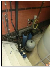
Waterontharder in ruimte zoutopslag
