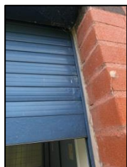
Corrosie t.p.v. lamellen
