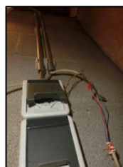
Beschadigde wcd met 'aanpassing'
