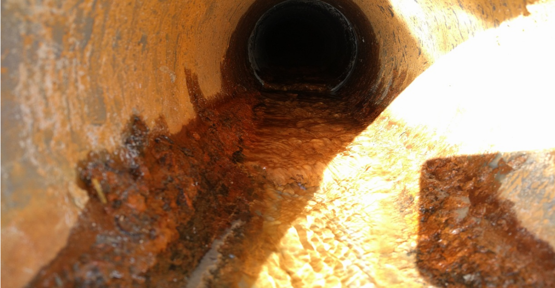
IJzerhoudende afzettingen in hemelwateruitstroomopening
