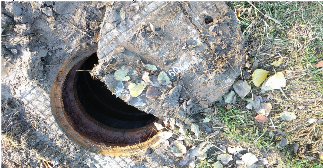
HWP09 (zuidoost-hoek), regelmatig water/prut bij put
