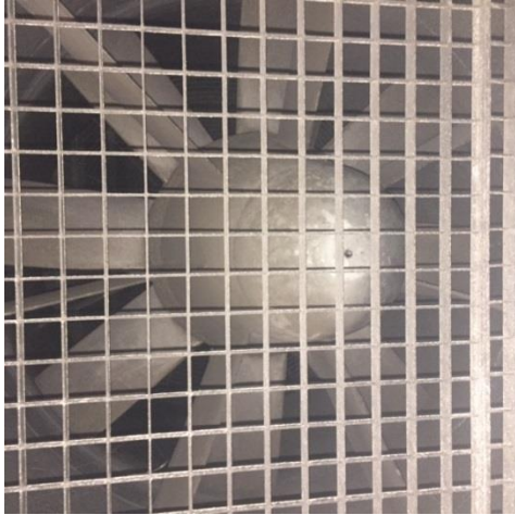
Foto 1: hoeveel ventilatoren (2 stuks)
